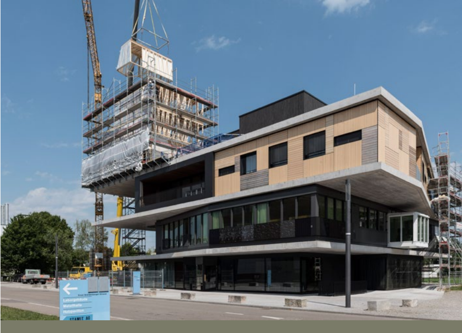
Auf den unteren Ebenen kann Etagenbebauung eingezogen werden, ohne dass sie ein Dach bräuchte.
